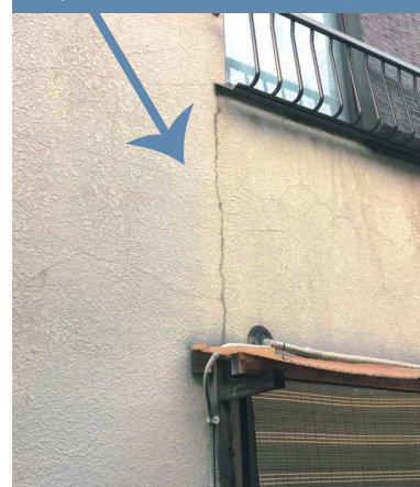
見た目で分かるひび割れ
